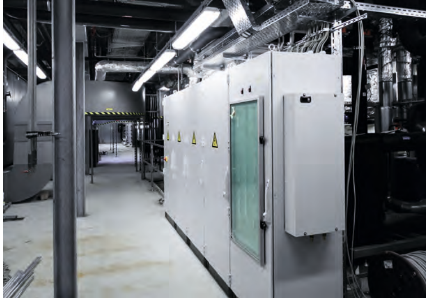
Chemikum Erlangen, Schaltschrank, L-Zentrale
