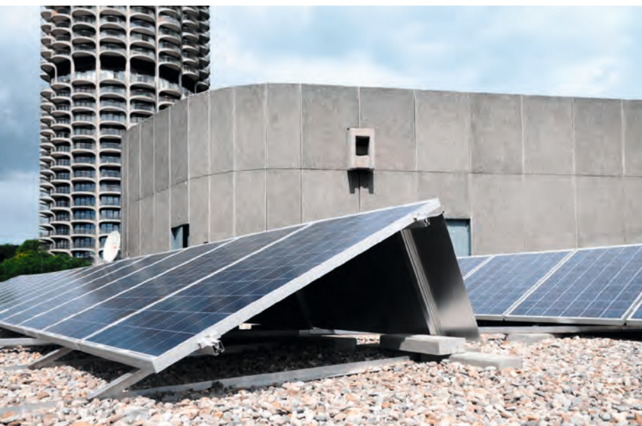
Stadtwerke Augsburg, Photovoltaik-Anlage, Kongresshalle
